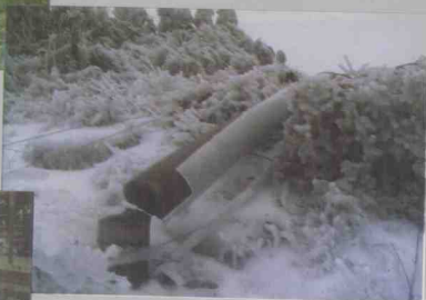
▲ 南雄县江头镇南甯管理区的高压供电线杆被冰雪压断
