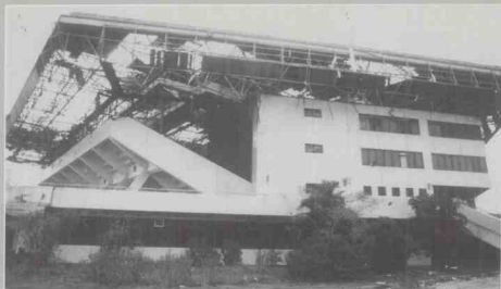
◀ 在1996年9615号台风中严重受损的湛江市体育中心
