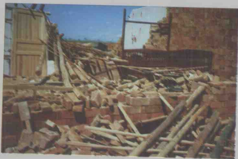
◀ 9615号台风中茂名市民 房受损情况
