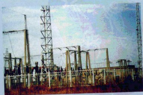
△库沙河变电站
