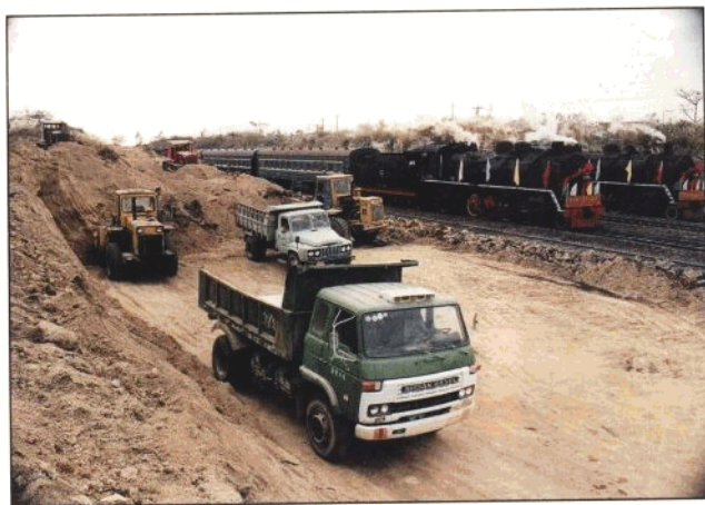
国务院批准建设琼州海峡铁路通道。1993年海南西环铁路扩建工程叉河至海口路段破土动工。 (蒙传雄 摄)
