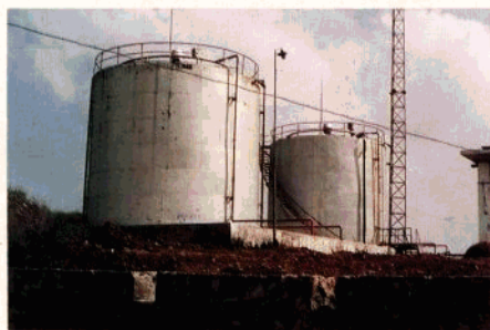
本公司制作安装的鞍钢实业公司轧钢厂 500m 3 油罐
