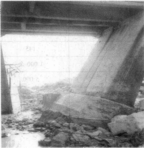
图 1.5 桥梁基础整体翻转
