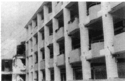
图 1.11 梁柱接头破坏
