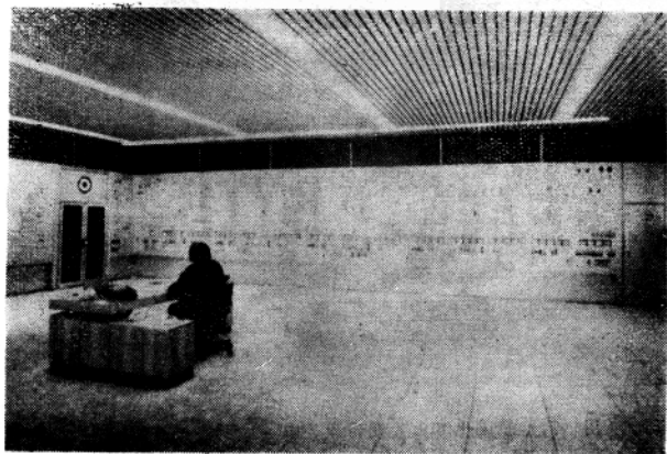
图 9. 管道化溶 出装置的 控制室
