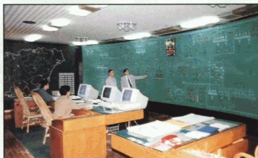
省电力中心调度所调度室。
