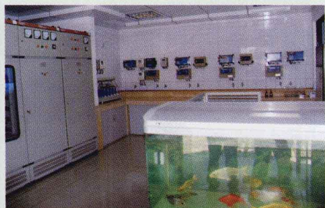
彩图 6-8 A 厂一体化布置的原水、工艺水、出厂水在线浊度、余氯、pH、流量在线仪表,生物监测水箱,水样采集专用水嘴
