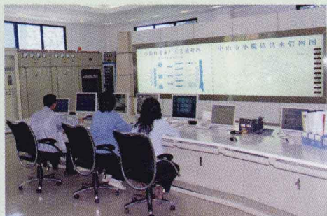
彩图 6-6 中央控制,使水处理过程及供水尽在掌控中
