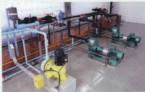
彩图 6-30 粉末活性炭混合投加设备,是常规工艺的一部分
