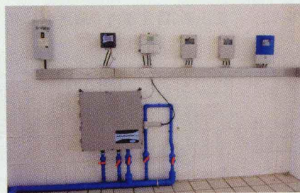
彩图 6-18 在新建 B 厂原水泵房配置的原水浑浊度、pH、流量、水位在线仪表,将水处理运行的基本数据第一时间传送到中央控制室
