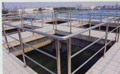
彩图 6-16 新建 B 厂增设配水池,均衡的配水,使水处理效果更稳定可靠,运行更经济
