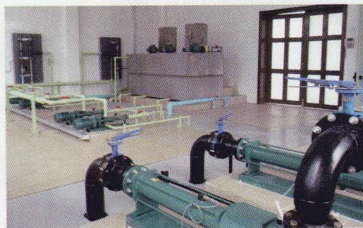
彩图 6-47 药剂投加设备,是污泥处理工艺不可缺少的一部分
