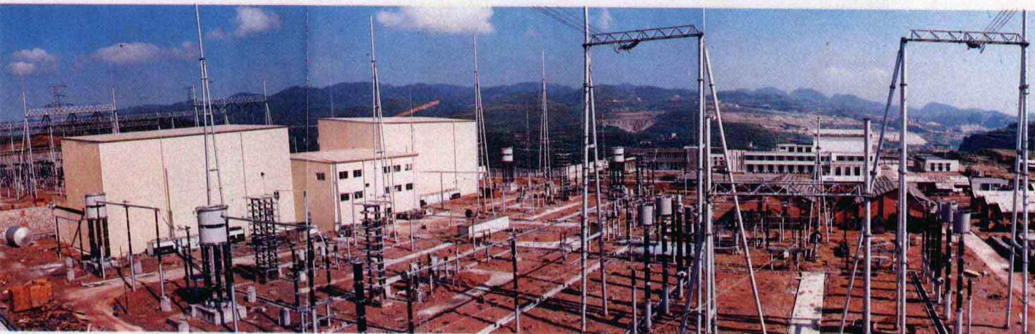
△ 葛洲坝水电站500 kV 换流站全景 陈伟摄
