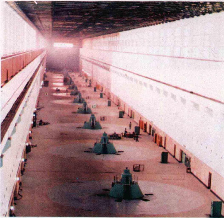
◁ 葛洲坝大江电厂发电机组大厅 李广全摄
