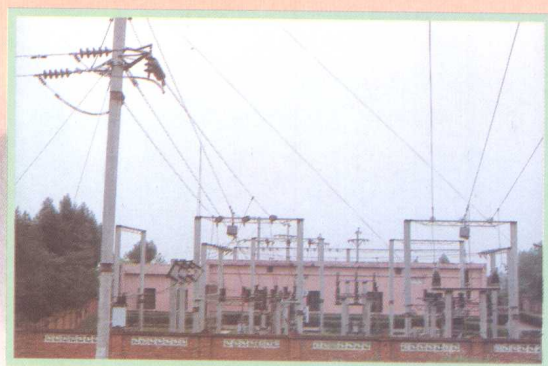
武引主变电站—梓潼供电站
