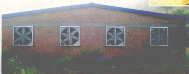
图1-9 纵向通风西墙(风机)
