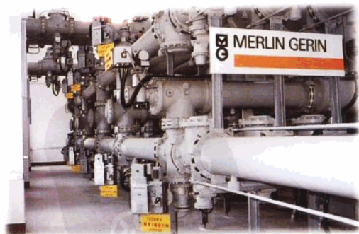
海南三亚鸭仔塘 220 千伏变电站引进使用的法国 MG 公司 GIS 组合电器
