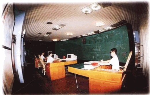
海南省电力中心调度所电网调度指挥中心
