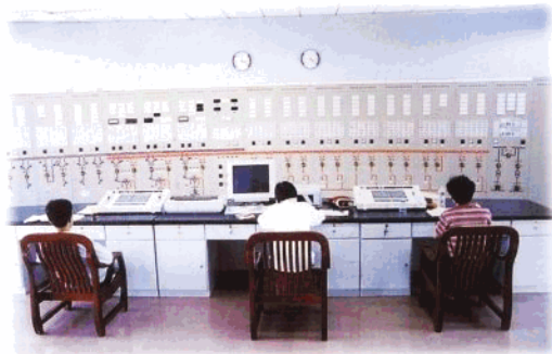
海南省 220 千伏玉洲变电站中控室
