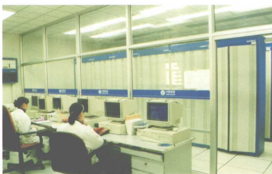
● 程控电话机房
