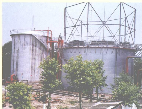
运行中的大型沼气工程一角
