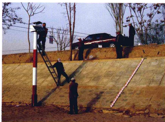
宁夏水权转换水位自动监测仪器安装调试
