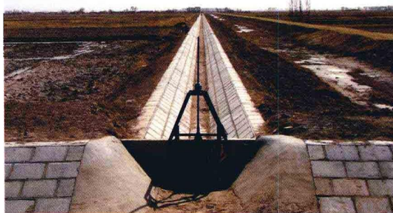
宁夏水权转换节水改造工程试点支渠水量 计量装置
