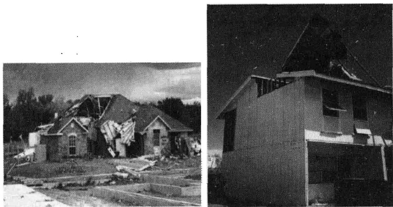
图 1-1 屋盖风荷载破坏图
