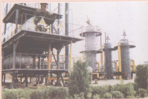
双阳首站净化工程设备群
