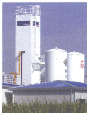
高纯氮设备 林德启东800m 3 /h
