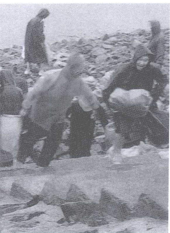
8月21日下午，苍南县大渔镇避风港防洪堤被大潮冲决，当地干部群众顶风冒雨，迅速组织抢修。 萧若驹摄
