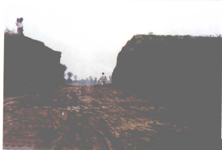
③ 被毁损的堤防工程
