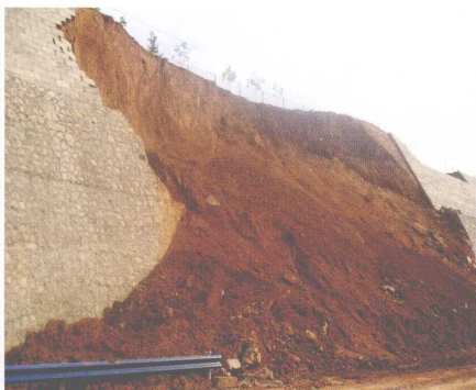
滑坡 (连霍高速公路洛阳段)
