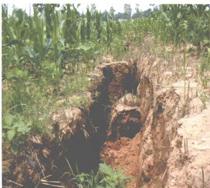
地裂缝 (河南省郑州市)
