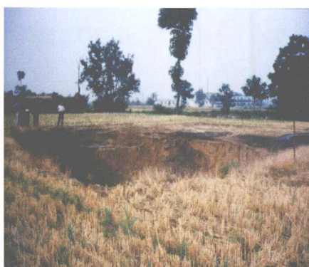
地面塌陷 (河南省安阳县)
