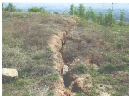
滑坡后缘裂缝(河南省巩义市)
