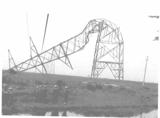
大港110千伏高压铁塔因风而毁
