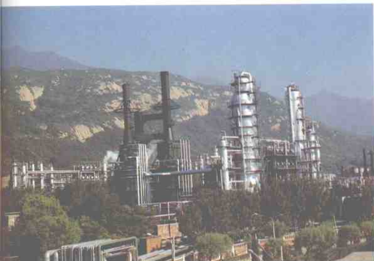
常减压蒸馏装置
