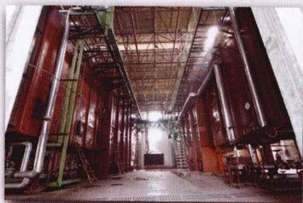
余热回收利用的锅炉房
