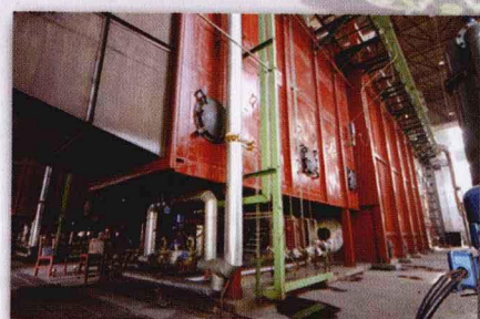
余热回收利用的锅炉
