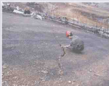
左岸垫层料坡面裂缝
