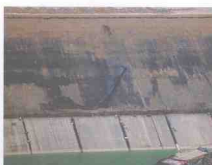
处理后的右岸垫层料坡面裂缝
