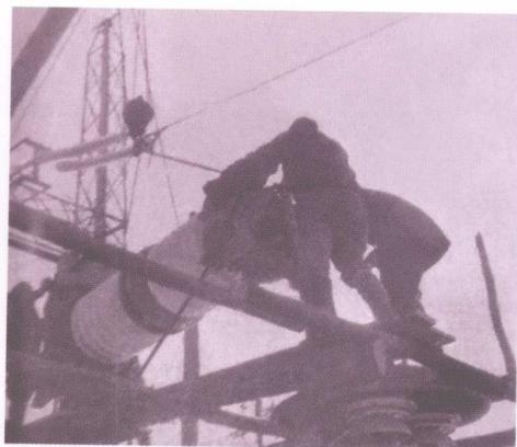
1942年，220千伏大连变电所设备安装
