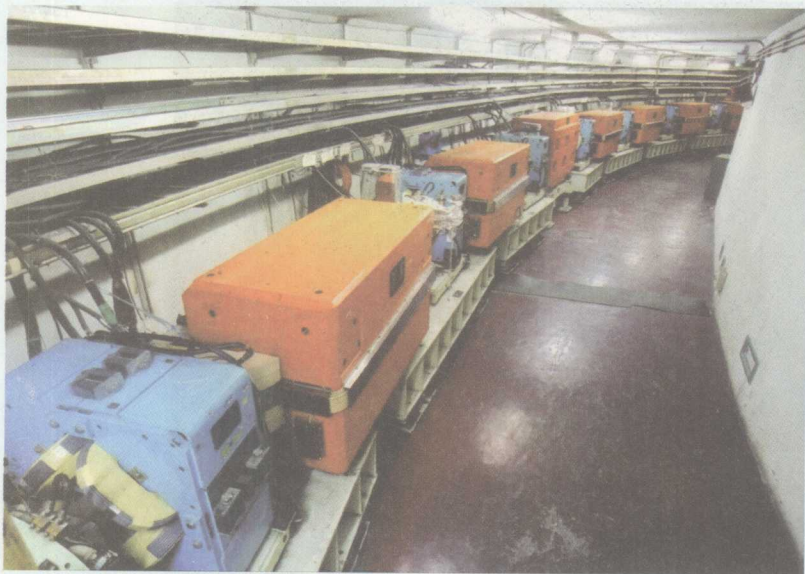
○ 北京正负电子对撞机储存环
