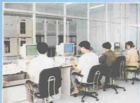
移动通信机房一角
