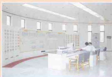
变电所主控室一角
