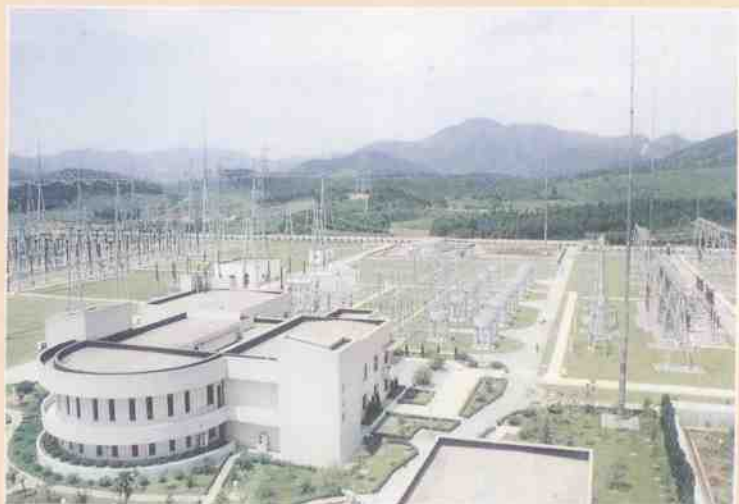
绍兴 500KV 兰亭变电所全景
