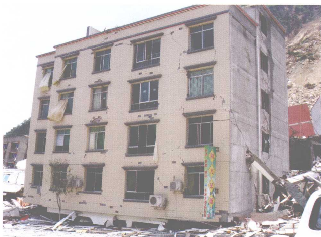
图 2.4 北川县城某底部框架房屋底层倒塌 (底层座落倒塌,上面4层砌体破坏较轻,窗下墙有明显十字交叉斜裂缝)
