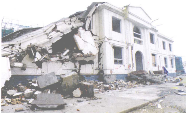
图 2.9 汶川县漩口镇某两层砌体结构房屋部分倒塌
