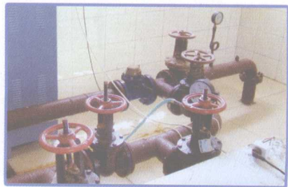
改造后的井泵房
