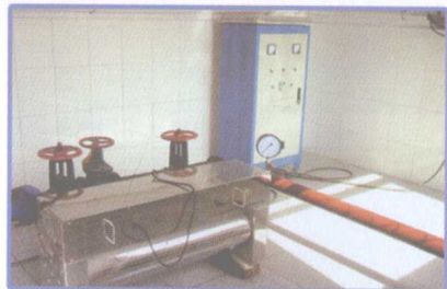
改造后的井泵房
