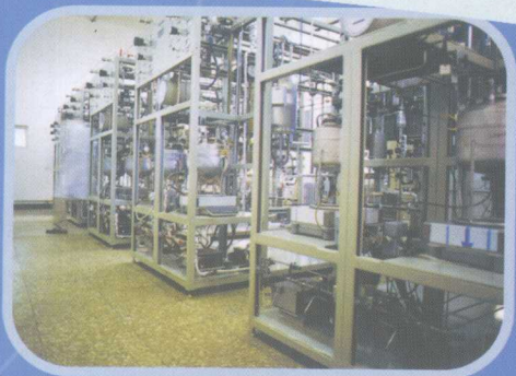
← ● 中压加氢中型试验装置
