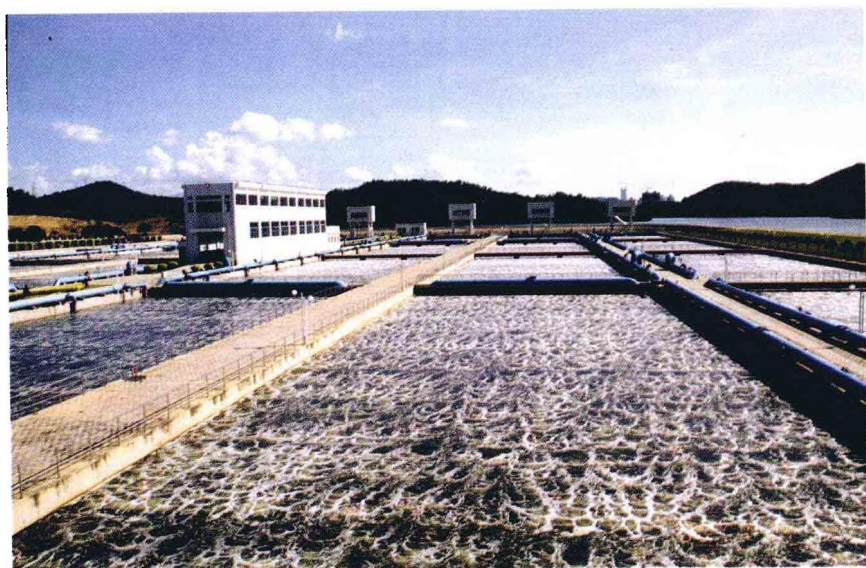
生物处理池由 6 条长 270m、宽 25m、深 5.5m 的过水廊道组成，池内正在均匀曝气
