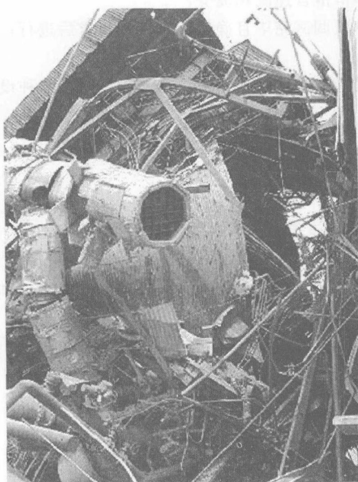
炸毁的锅炉和管道
