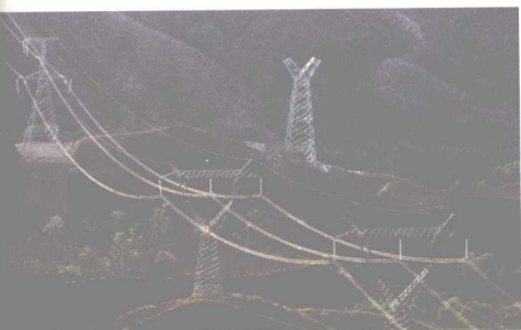
西电东送的电力铁塔。
