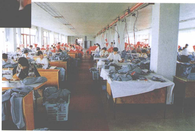
上海稚新制衣有限公司装有中央 空调的缝纫车间
