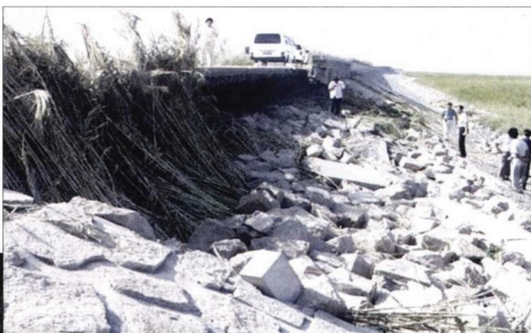
2000 年 8 月 底，受“派比安” 台风严重影响， 局部海塘受损。
