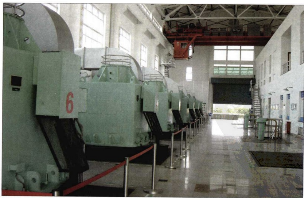
市区防汛排水泵站
