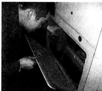
图 1—1—6 随意拆装电气设备
