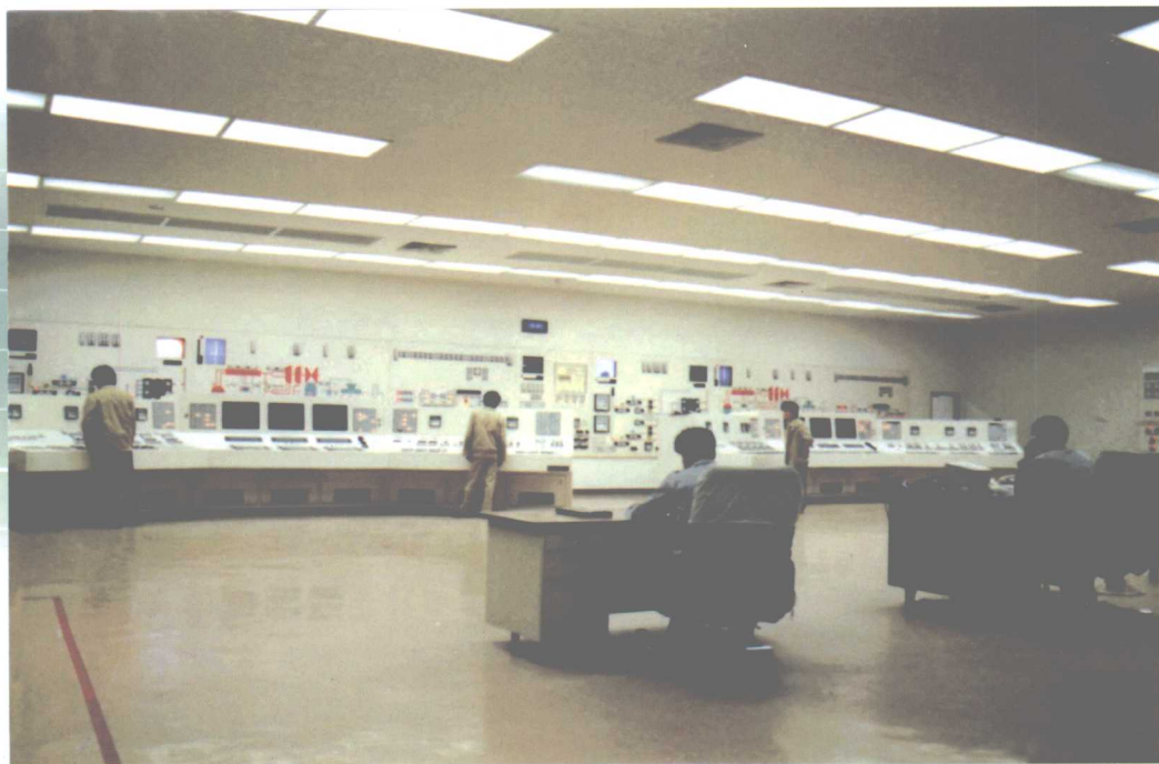
图2 1988年投产的成套进口福州电厂 2 \times 350\text{MW} 机组 MIDAS-8000 (DAS、MCS、DEH、FSSS、MEH) , SCS (PLC)
