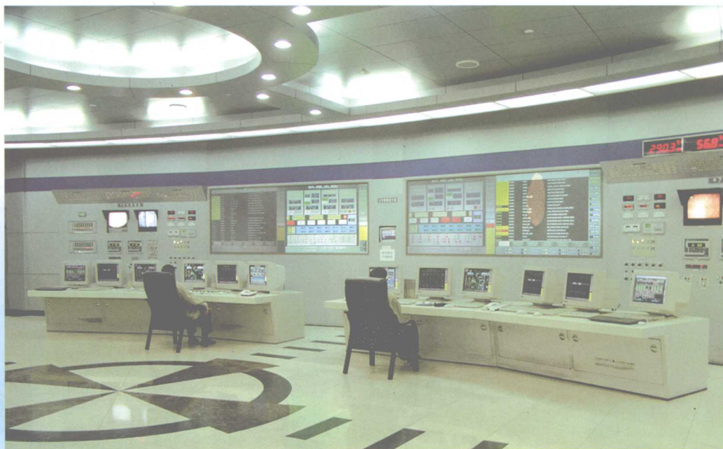
图9 2001年投产的张家口电厂#7、8机组 ( 2 \times 300\text{MW} ) MAX-1000plus (DAS、MCS、SCS、FSSS、ECS) + ABB的DEH、MEH
