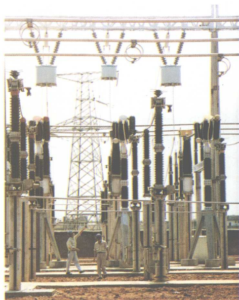
220KV 升压站一瞥
