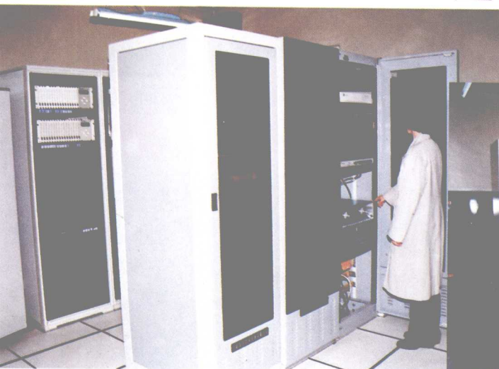
白城市邮电局数据通信机房
