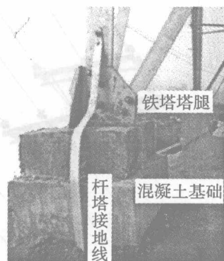
图 1-3 架空线路铁塔基础 及杆塔接地实景
