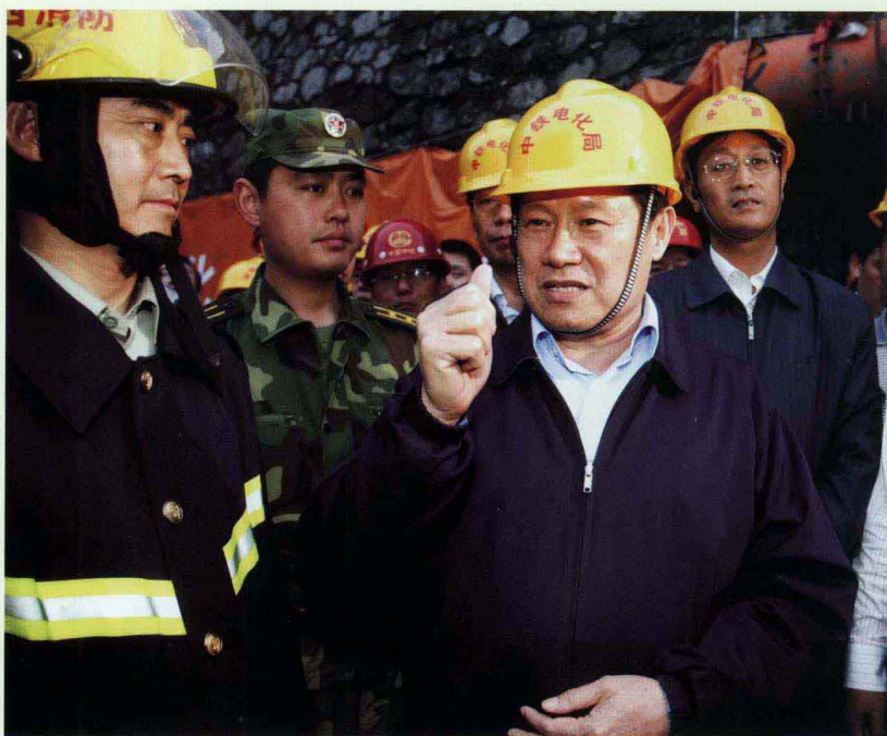
► 5月15日，中共中央政治局常委、中央政法委书记周永康在宝成铁路109隧道塌方现场考察指导抢险工作，看望慰问抢险人员
