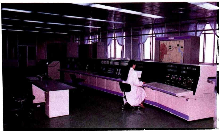
中日人民友好水厂 中心控制室
