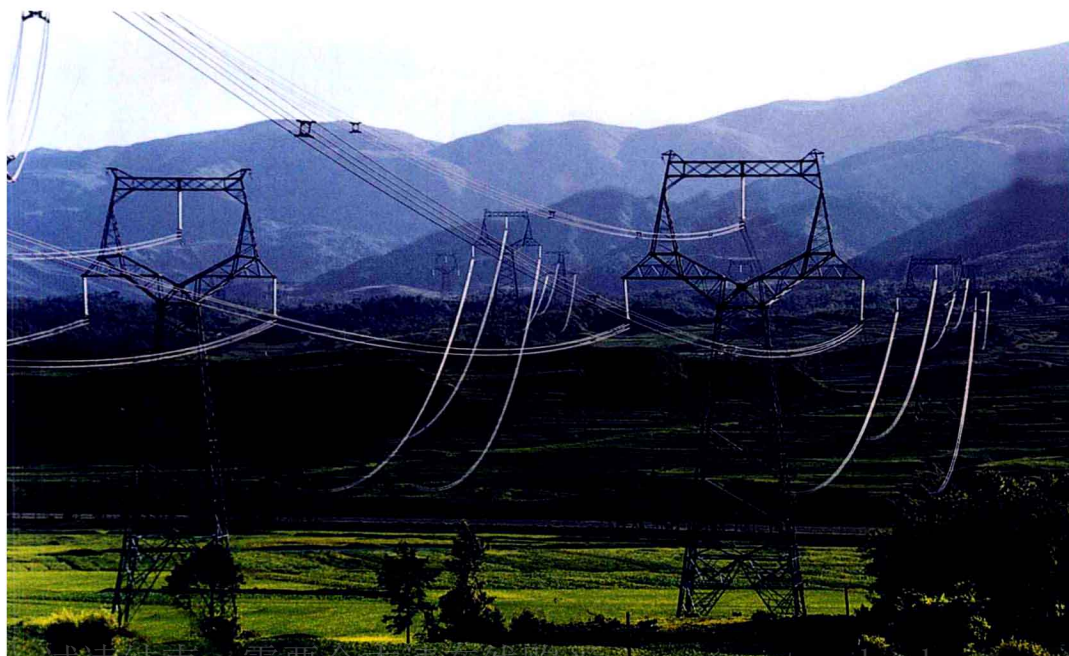
■ 四川二滩—自贡一、二回500千伏输电线路的雄姿。
