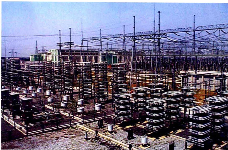
■ 位于湖北宜昌的±500千伏龙泉换流站。
