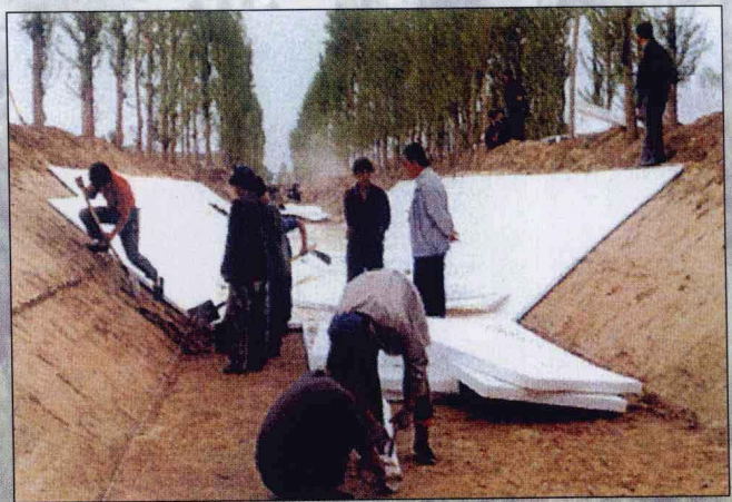
河套灌区采用聚苯乙烯保温板消除衬砌渠道的冻胀破坏
