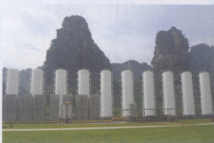
10×100m 3 /d LNG汽化站
