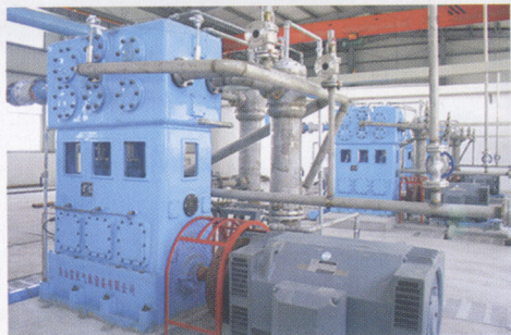
550m 3 /h 中压氧气压缩机
