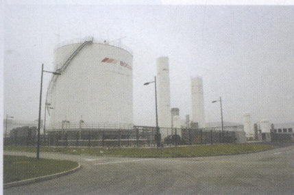
3000m 3 低温液体贮槽
