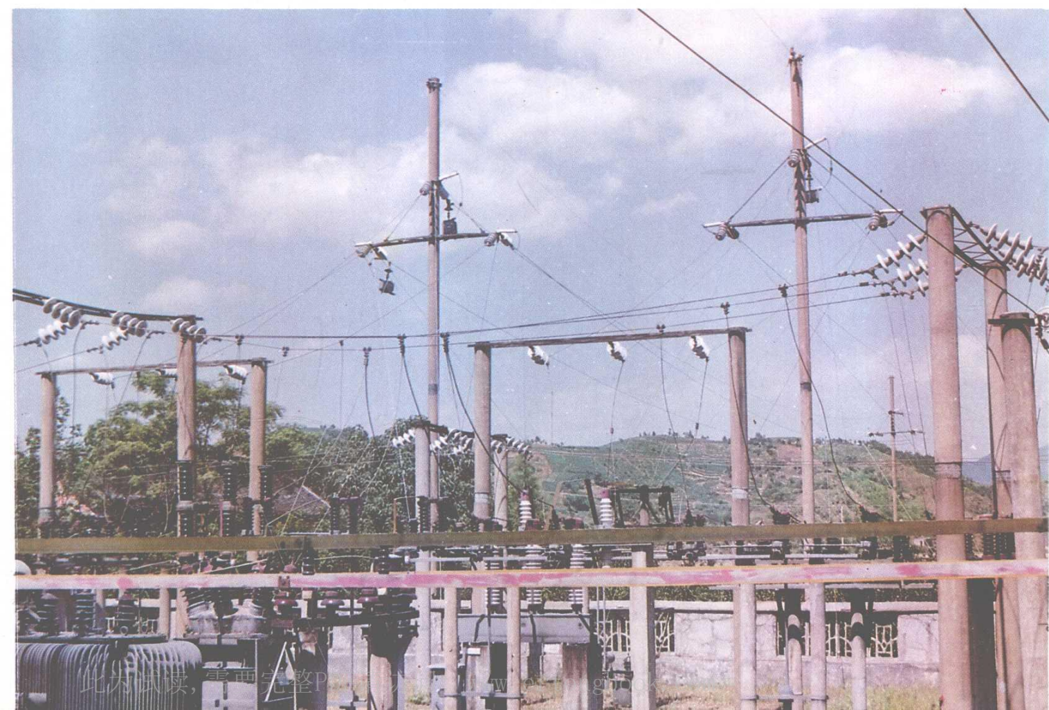
人民电站变电站
