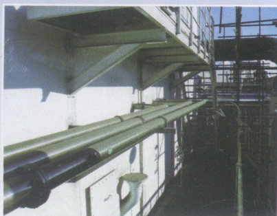
● 高真空多层绝热低温液体输送管道用户使用现场
