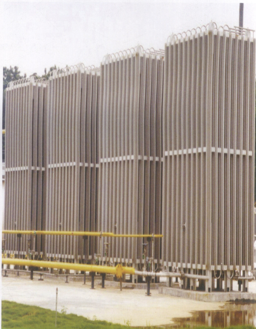
高、低压空温式气化器(设计/制造能力单台可达8000m 3 /h)
