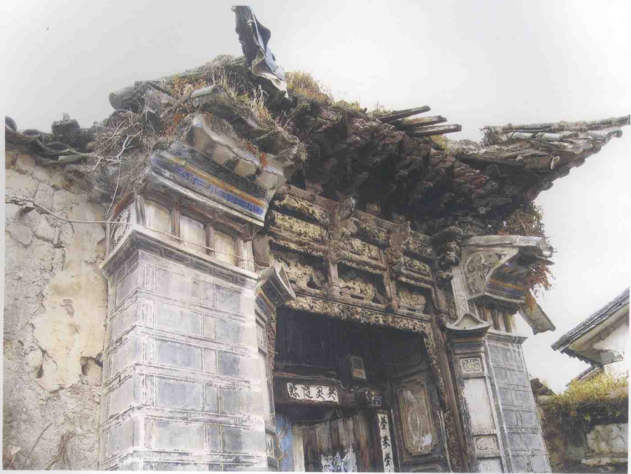
1.木雕三斗三升三滴水大门（明代，大理周城） 门头虽然已面目全非，但上好的木材和工艺见证了当年房主人的富裕。
