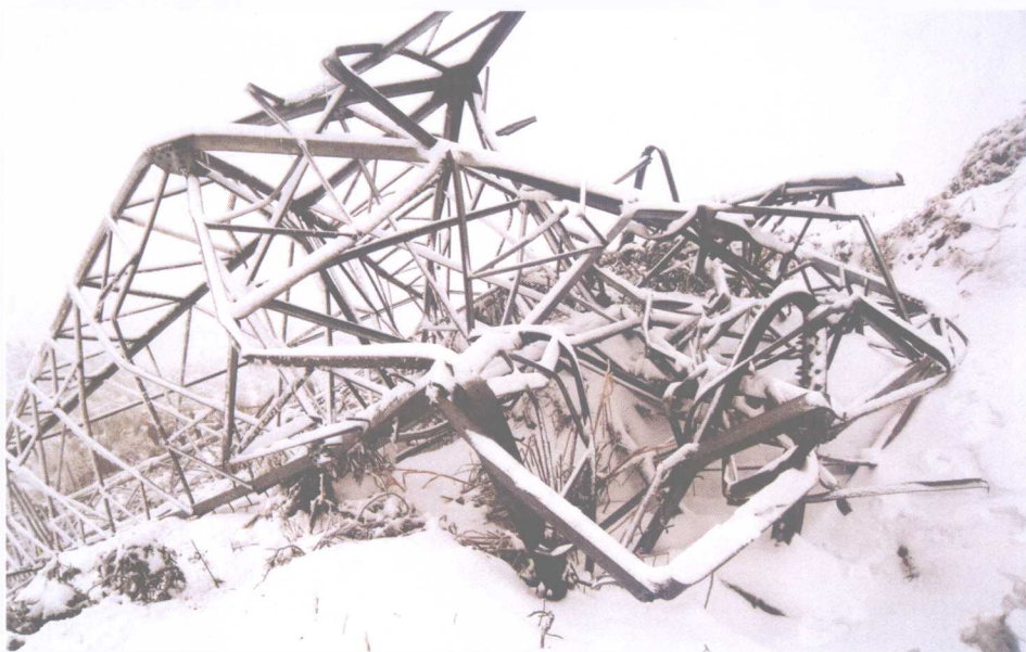
50年不遇的风雪对湖北电网造成了严重损害。
